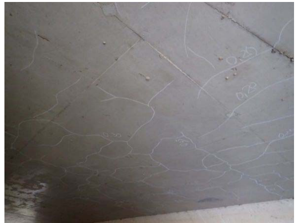
コンクリート床版のひびわれ
