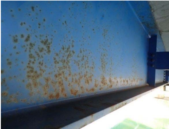
鋼橋の防食機能の劣化
