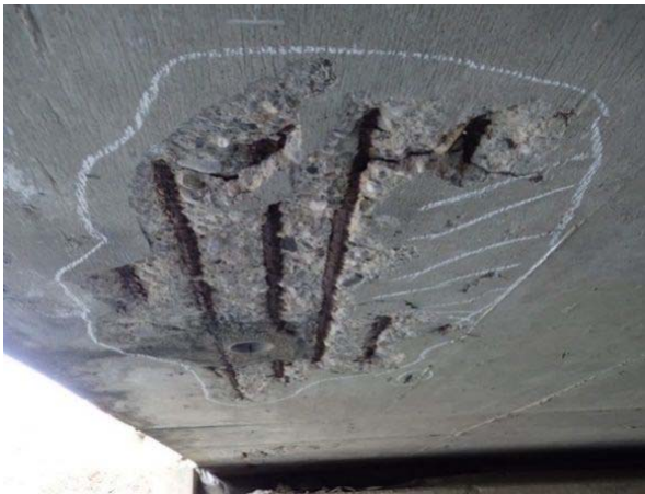
コンクリートの剥離・鉄筋露出
