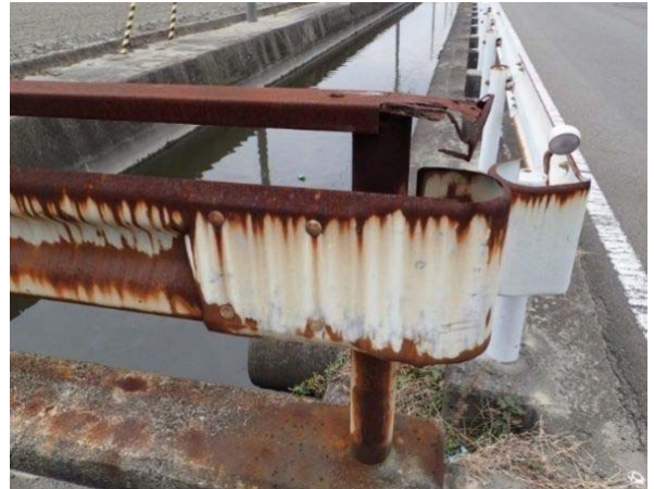
ガードレールの腐食
