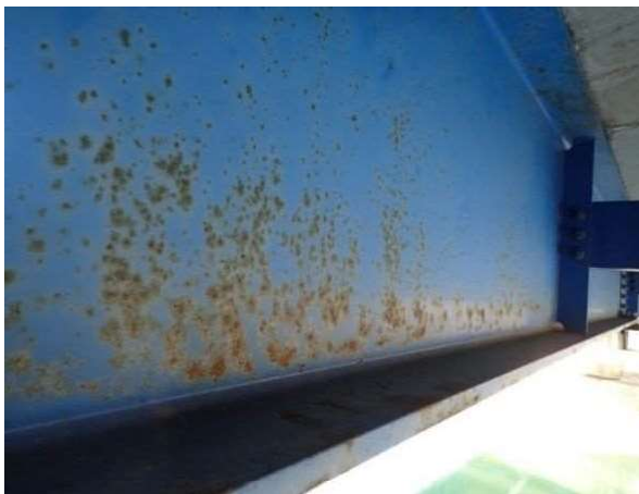
鋼橋の防食機能の劣化
