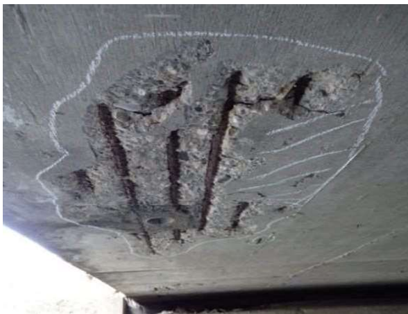
コンクリートの剥離・鉄筋露出
