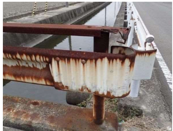
ガードレールの腐食
