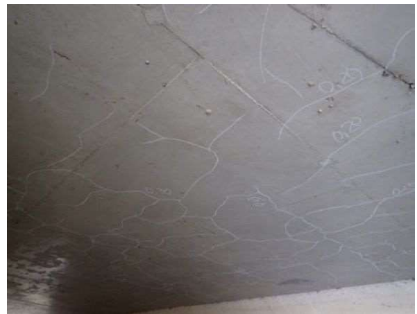
コンクリート床版のひびわれ
