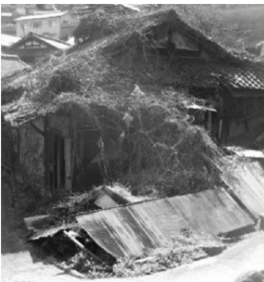
特定空家等（老朽化が進み、倒壊等の危険性大）
