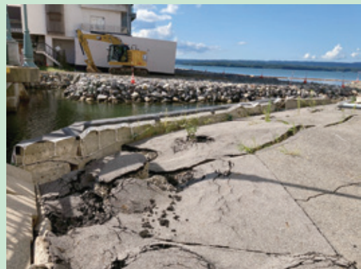
和倉町被災状況
