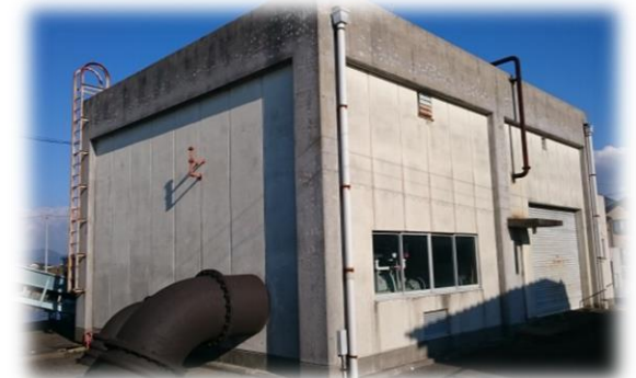
豊岡排水機場
